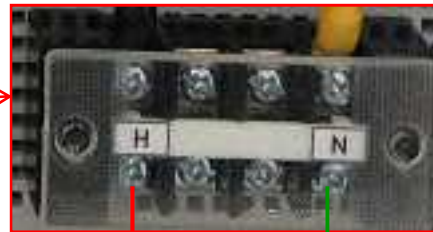
컨트롤러 내부 단자대
